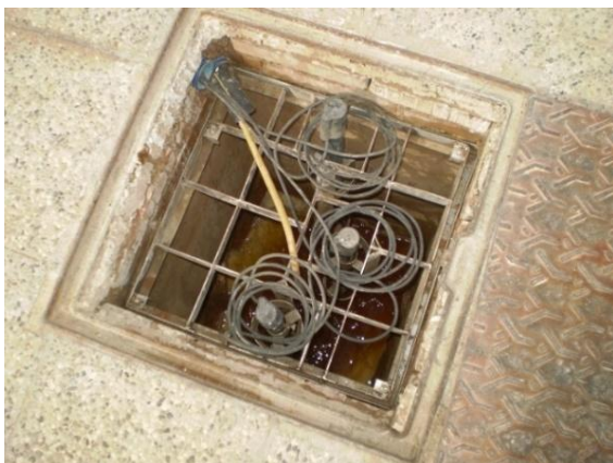
Figura 9 Pozzetto di campionamento
