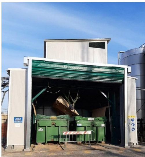
Figura 11 Particolare della filtropressa
