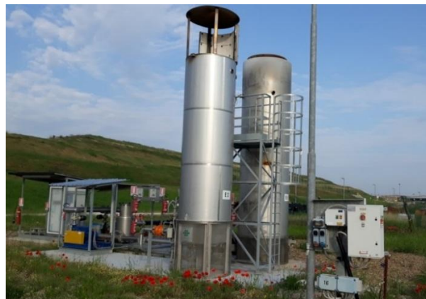
Figura 34 Torcia di combustione biogas
