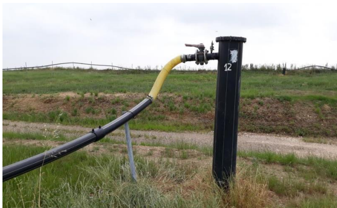
Figura 33 Pozzo di captazione biogas
