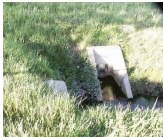
Figura 51 Punto di scarico S1/B
