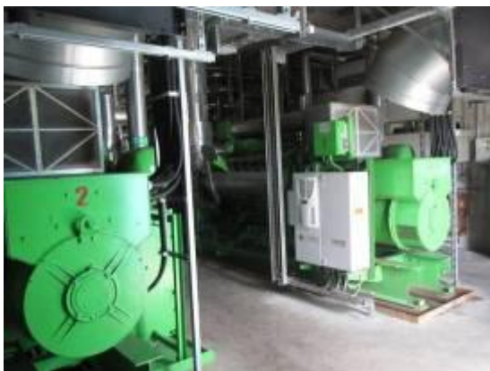
Figura 10 Gruppi di cogenerazione
