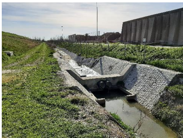
Figura 50 Punto di scarico S1/C
