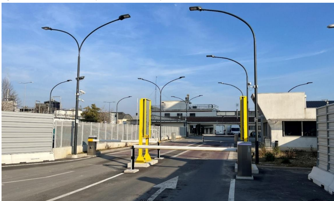
Figura 4 Portale radiometrico e pesa a servizio dell'impianto
