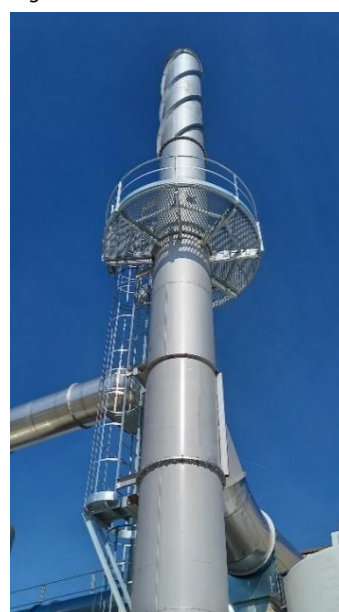
Figura 15 Particolare Emissione E1
